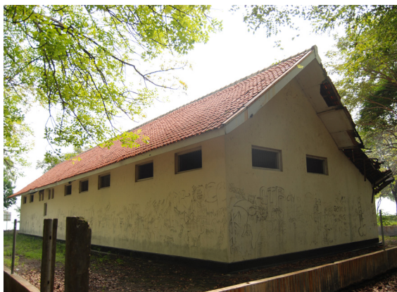
Gambar 1. Salah satu bangunan yang terdapat di P. Onrust yang sudah mulai rusak tidak terawat
